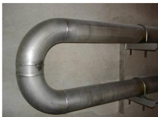
Figure 10 Serpentins de chauffage sur le digesteur et le post digesteur
